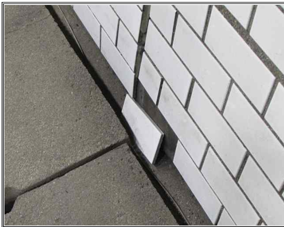
위 치 벽체 S8 내 용 타일탈락
