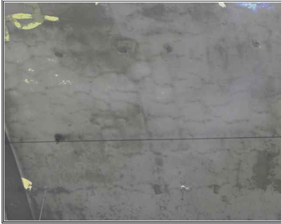
위 치 라이닝 S3 내 용 망상균열
