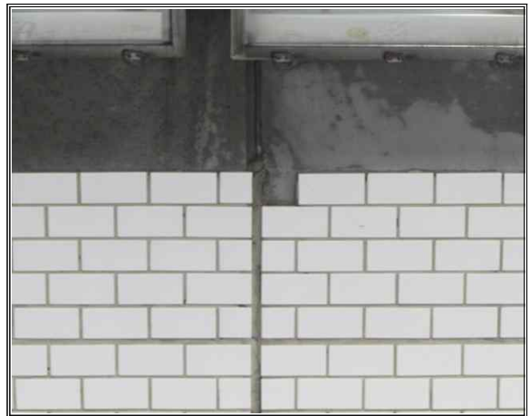
위 치 벽체 S10 내 용 타일탈락
