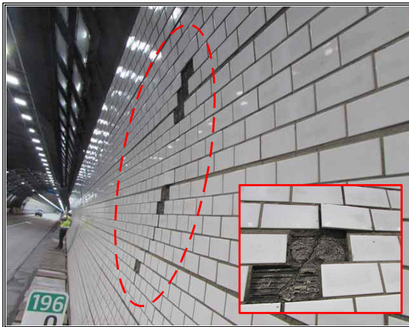
위 치 벽체 S5 내 용 타일들뜸 및 탈락
