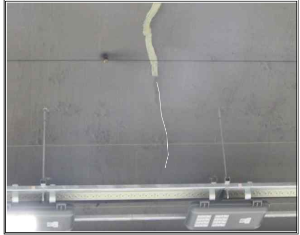
위 치 라이닝 S4 내 용 균열(0.3mm이상)
